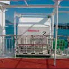
シューター格納庫
